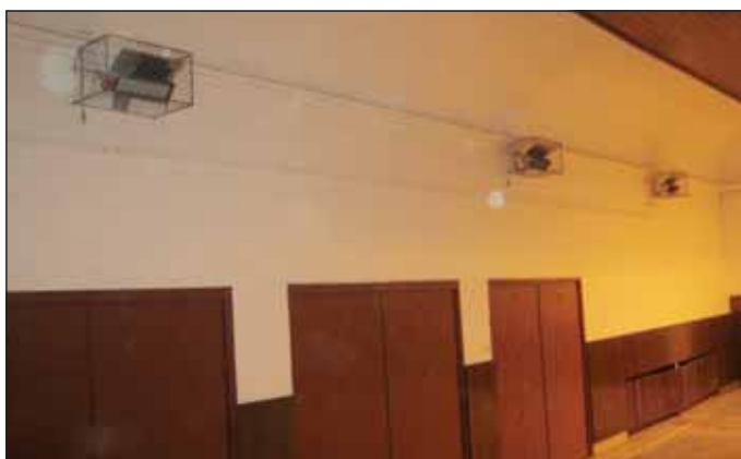
Velká tělocvična s plynovými přímotopy po provedené plynofikaci sokolovny v roce 2002.
