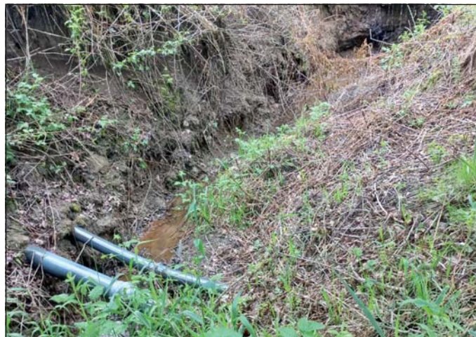
Takto vypadal propust a odhalený vodovodní řad po loňských povodních.
